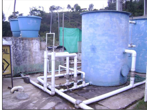
Foto 40. Planta de tratamiento del Acueducto AGUPLAN. Se aprecian fugas de agua en las áreas de las tuberías
