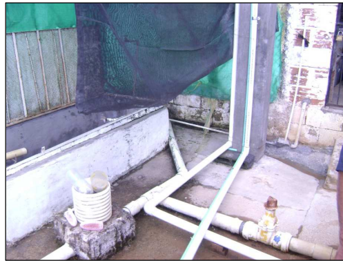
Foto 41. Planta de tratamiento del Acueducto AGUPLAN
