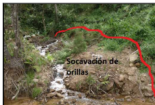
Foto 13. Socavación de orillas.
