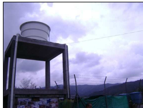
Foto 38. Nuevo tanque de almacenamiento
