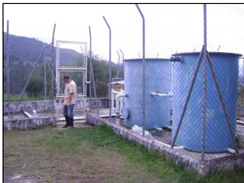
Foto 37. Tanque principal de almacenamiento
