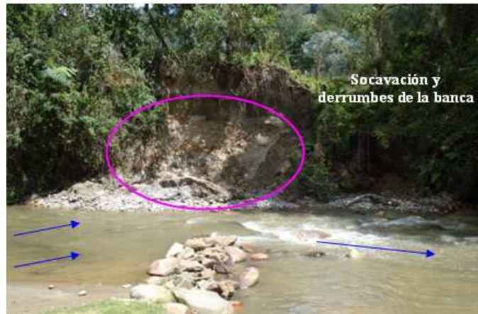
Foto 12. Socavación y derrumbes de la banca.
