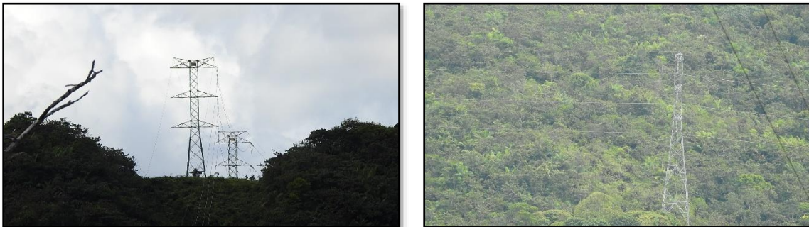
Fotografía 1. Red de transmisión eléctrica en el DRMI Cuervos. Tomada por: Ángela Rivero, Cornare.
