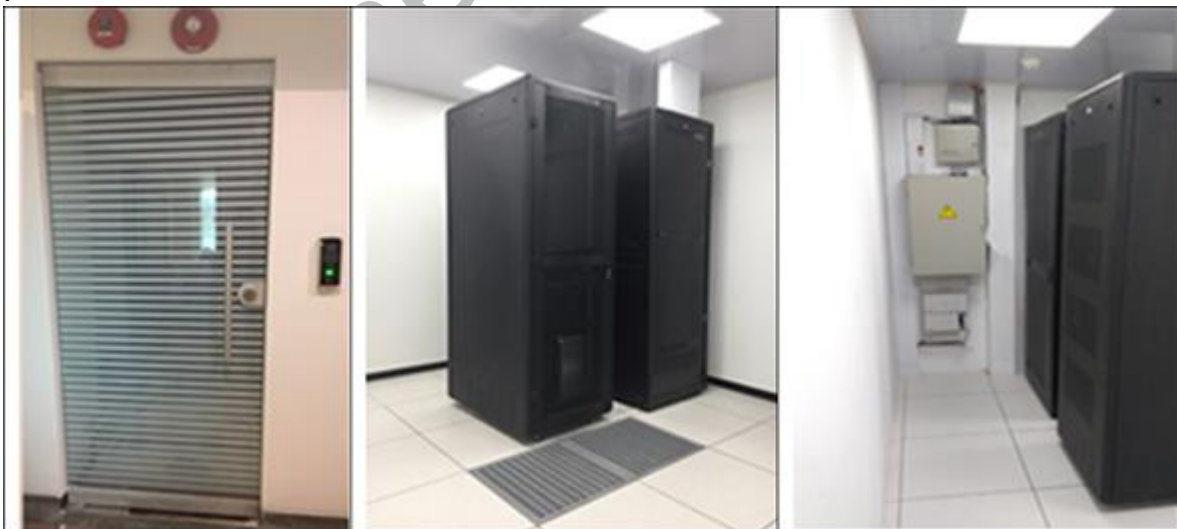
Figura 51. Datacenter Corpoboyacá Fuente: Soporte Tecnológico
