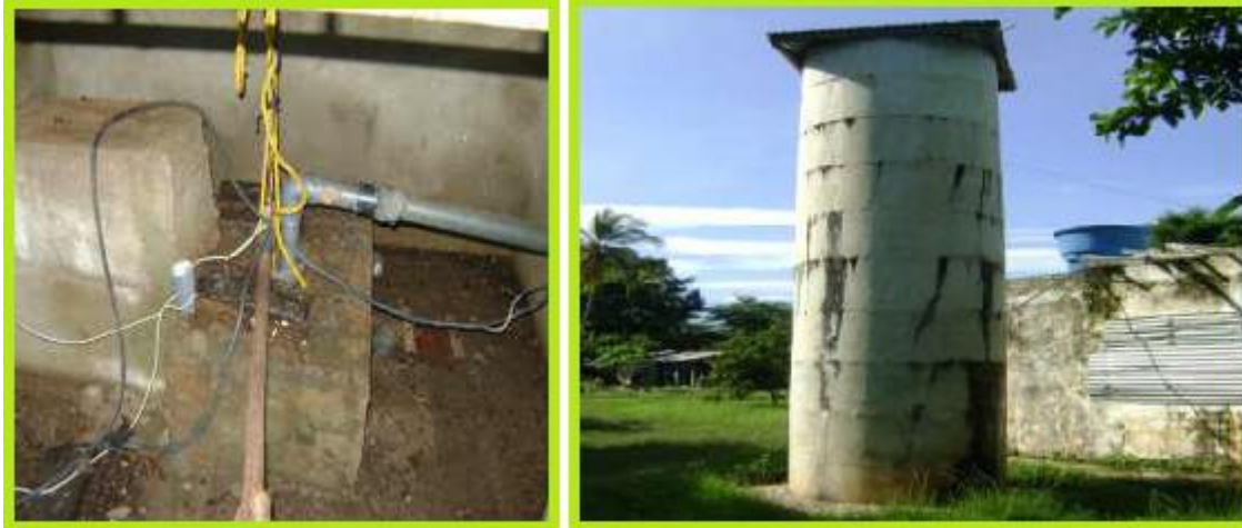
Figura 4-15. Estación de bombeo y tanque de almacenamiento del Pozo Santa María
