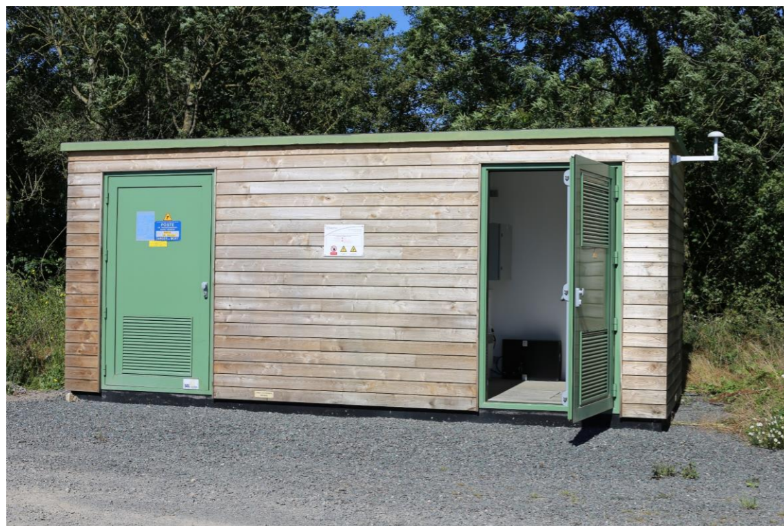
Photo 152 – Exemple de poste de livraison habillé d'un bardage en bois (Source : AEPE-Gingko)
