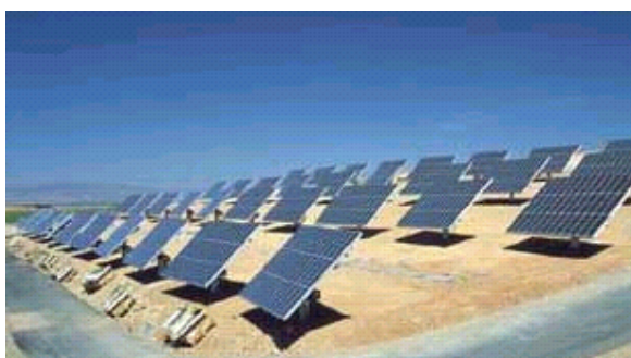
Figure 67: Centrale de Tudela en Navarre 60
