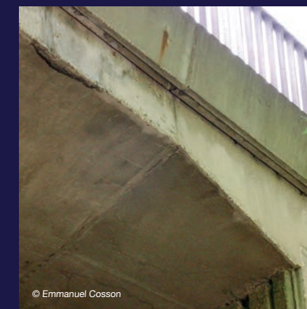
Gîte potentiel dans le joint d'un pont.
