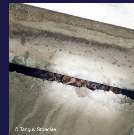
Petite colonie dans le disjointement d'un pont.
