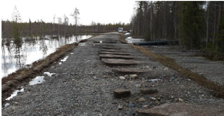
Kuva 42. Tulvan vaurioittama tie (kuva: Lapin ELY-keskus).
