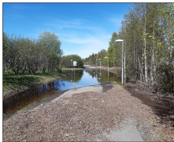
Kuva 32: Tulva on kuljettanut mukanaan roskia tielle, jotka täytyy siivota tulvan jälkeen (kuva: Lapin ELY-keskus).
