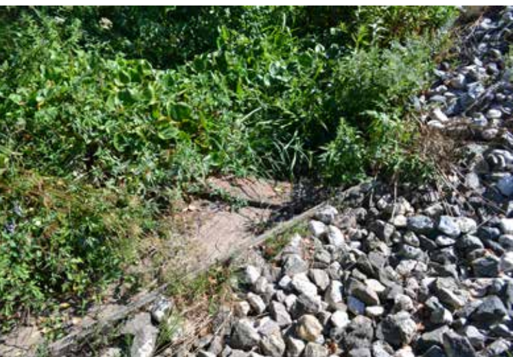
Gräggböleträsketin luusuassa sijaitsevat 1990-luvun alkupuolella rakennetut pohjapato ja betoniset kalaportaat. Järven vedenpinta noudattelee padon korkeutta. Kuva: Pasi Salmi
