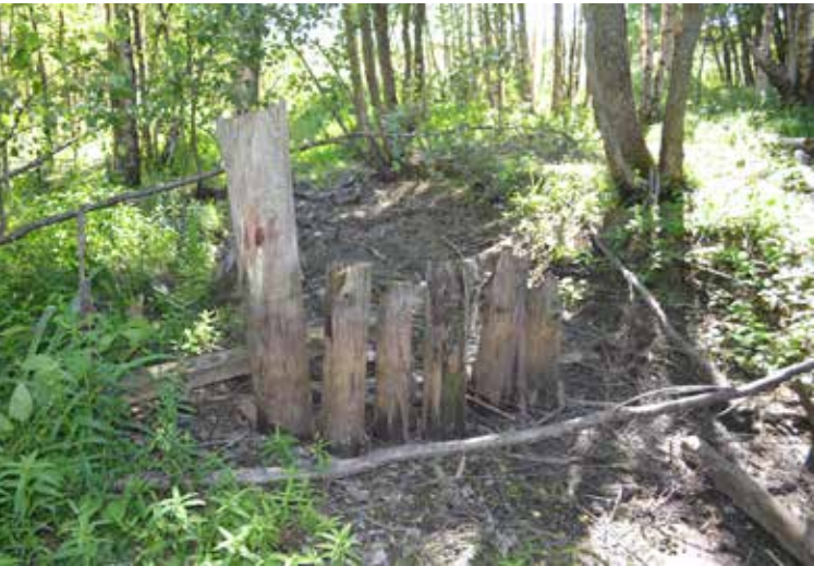
Mustfinträsketin veden korkeutta on aiemmin säädelty laskuojassa olleen lankkupadon avulla, mutta nykyisin pato on erittäin huonokuntoinen eikä siten täytä enää tarkoitustaan. Kuva: Pasi Salmi
