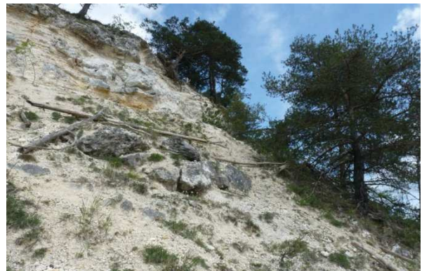
Figure 3 : délitement du calcaire d'Etampes sur les sables de Fontainebleau (La Chapelle-la-Reine ; 77)
