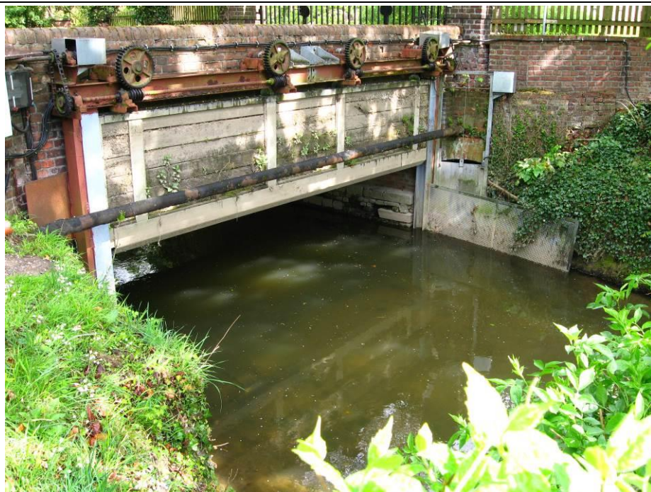
Wehranlage zur Speisung der Gräfte Schloss Heltorf
