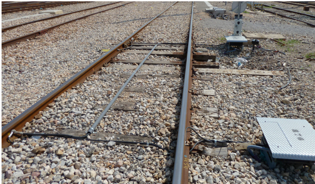
Figura 15. Detalle de un lazo de separación de circuitos de vía
