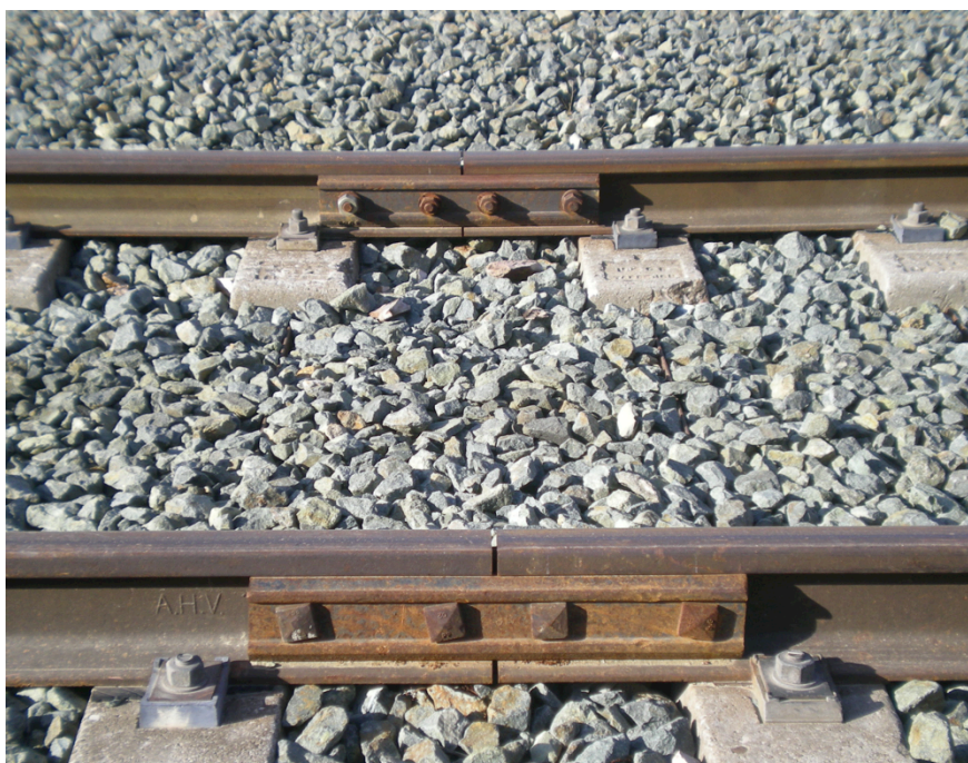
Figura 1. Unión mecánica de los carriles mediante bridas.
