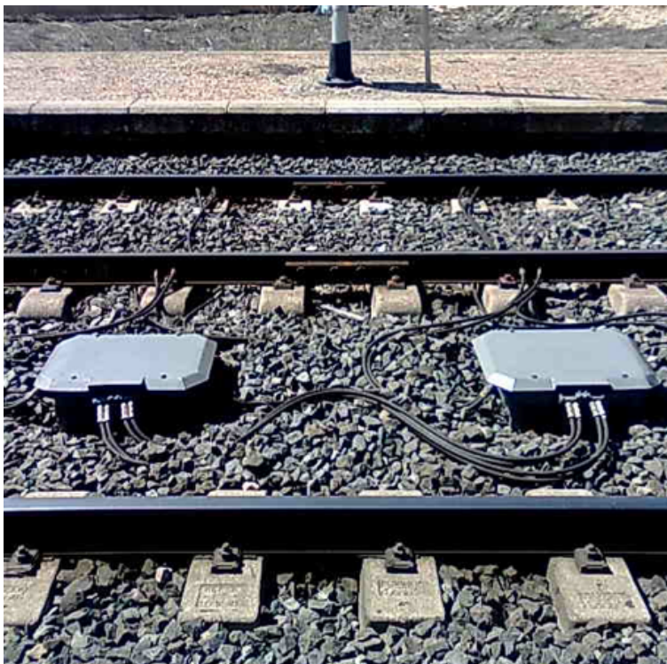
Figura 11. Detalle de conexión de circuito de vía con junta inductiva de bicarril a bicarril
