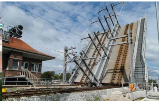
Abb. 9: Beide neue Klappbrücken mit Oberleitungs-sonderkonstruktion
