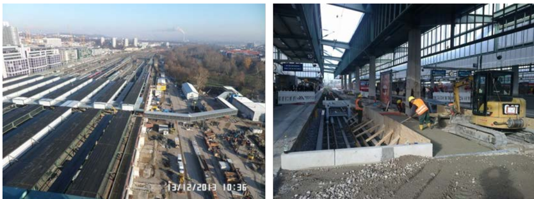
Abb. 32: Blick auf das neue Gleisvorfeld und Schlossgartensteg und Bau des Querbahnsteigs für das neue Gleisvorfeld; Quelle: Züblin
