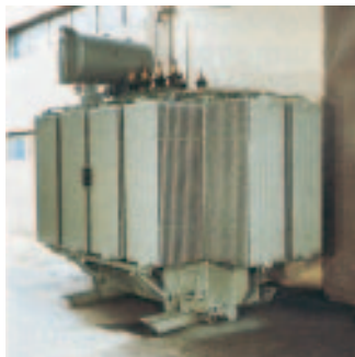
(α) ΑΜ/Σ 10.000kVA, 15/20kV
