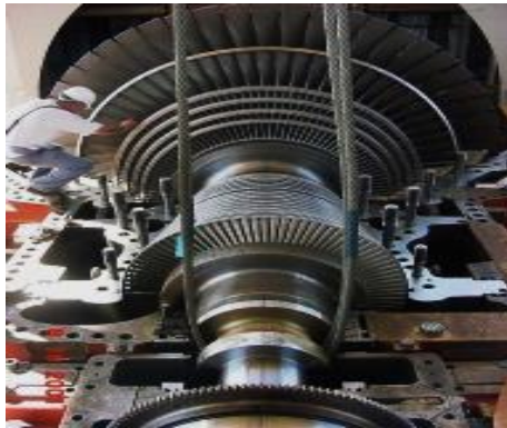
Figura 3.15 Rotor de turbina durante una revisión
