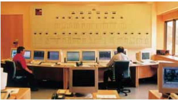
Régua Remote Control Centre
