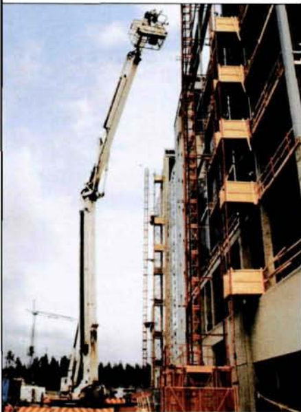
Müllverbrennungsanlage für die Wärme- und Stromerzeugung in Umeå
