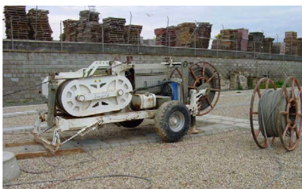
Cabrestante tipo. Fuente: Red Eléctrica.
