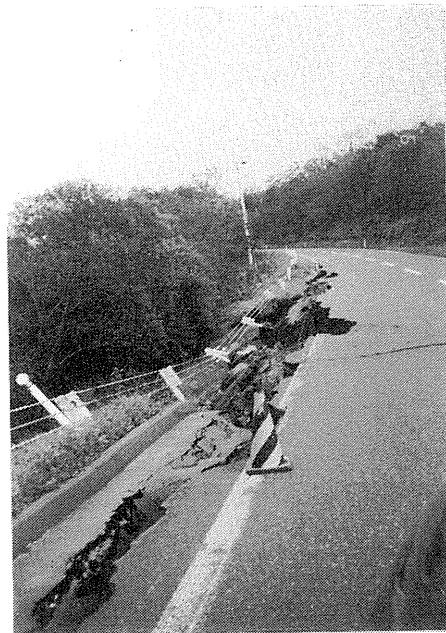
写真-4.2.6 道道283号線の路肩の崩壊 計根別から常盤橋に向かう道路で盛土崩壊により路面が陥没していた。ここは当幌川の支流を横切るために盛土されていた。 Photo-4.2.6 Sliding of Road Embankment Filled parts of embankment crossing a small valley collapsed.
