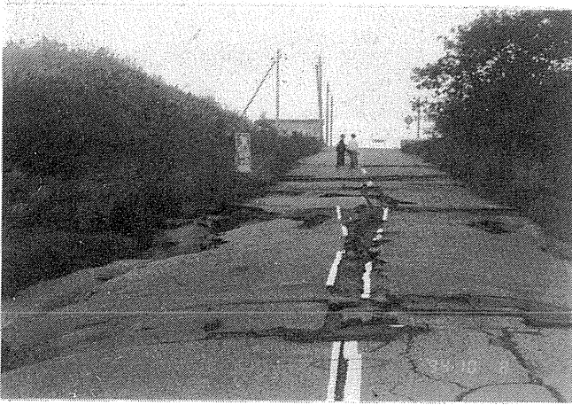
写真-4.2.11 東十条地区の坂の滑り 斜面を掘削して造られた坂が滑りによりひび割れを生じた。 Photo-4.2.11 Slope Deformation (Higashi Jujo District)
