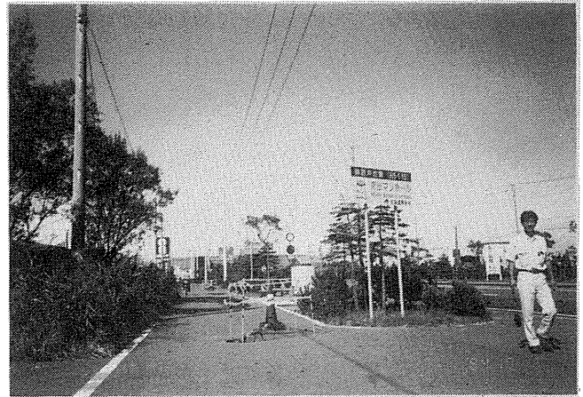
写真-3.2.3 釧路町木場におけるマンホールの浮上 ここは前回の釧路沖地震でも約1.3m浮上した箇所であり、今回は約20cm程度の浮上量であった。なお、写真後方の植樹帯の中には、釧路沖地震で突出したマンホールが展示されている。
