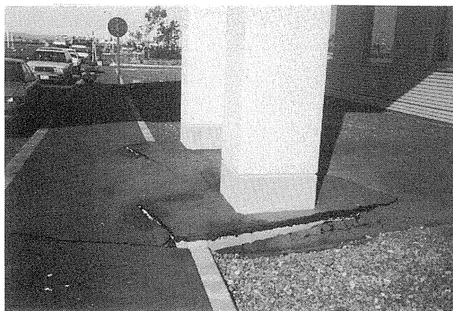
写真-3.1.7 漁業埠頭マリントポスクシロの周辺地盤の沈下 建物本体および護岸部にはほとんど変状は認められなかったが、建物の周辺地盤で若干亀裂・沈下が生じていた。
