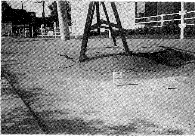
写真-3.2.2 今回の地震によるサティ（旧ニチイ）前のマンホールの浮上 浮上量は前回よりも小さいが、他の箇所でも同様に浮上していた。
