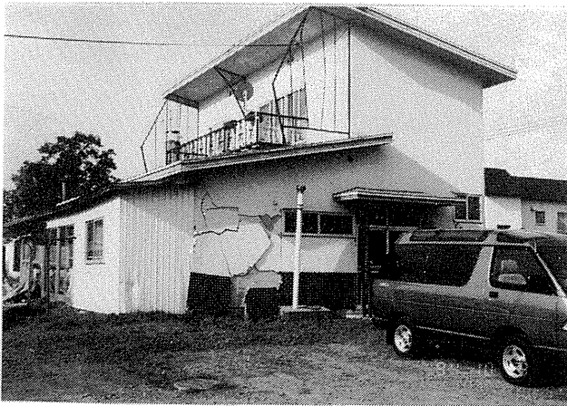
写真-4.2.9 南6丁目地区の建物の被害(その2) 地震動により、モルタル外壁が剥離した。この付近では、多くの建物で同様の被害が発生している。
