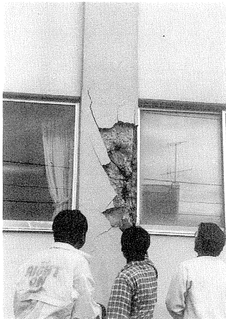
写真-5.1.7 有磯町の根室市立病院の柱の被害 柱外壁が落下した。 Photo-5.1.7 Shear Crack of Column of Nemuro Public Hospital
