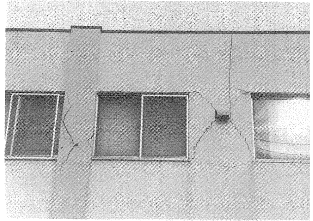
写真-5.1.6 有磯町の根室市立病院の外壁、及び柱の被害 せん断破壊により外壁に亀裂が発生した。 Photo-5.1.6 Shear Cracks of Walls and Columns of Nemuro Public Hospital
