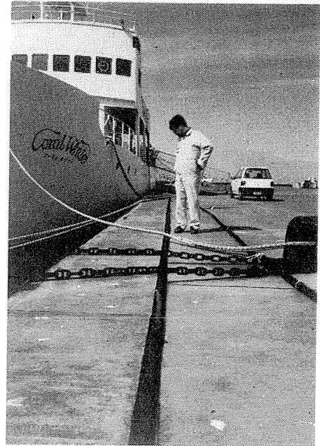
写真-5.1.10 根室港東側埠頭のエプロン部の沈下 エプロン部が約10cm沈下した。 Photo-5.1.10 Subsidence at Nemuro Port
