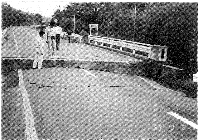
写真-4.2.5 常盤橋の橋台裏込土の沈下 道道283号線当幌川にかかる常盤橋の橋台裏込土が約50cm沈下し、通行止めになっていた。橋梁本体に被害は見られなかった。 Photo-4.2.5 Ground Subsidence at The Tokiwa Bridge The ground behind the abutment subsided 50 cm, No damage to the bridge structure was observed.
