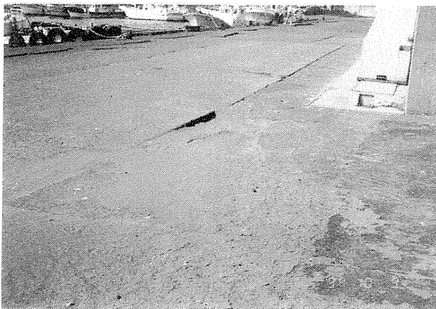
写真-5.2.2 花咲港地区Aエプロン部の噴砂 エプロン部の亀裂周辺では噴砂が見られた。 Photo-5.2.2 Sand Boil (Point A)
