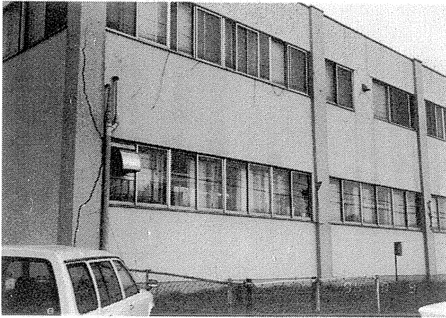
写真-5.1.5 有磯町の根室市立病院の外壁、及び柱の被害 外壁、及び柱に亀裂が発生した。 Photo-5.1.5 Shear Cracks of Walls and Columns of Nemuro Public Hospital
