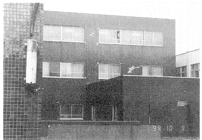
写真-5.1.8 有磯町の根室市立病院の外壁、及び柱の被害 外壁に亀裂が発生した。 Photo-5.1.8 Shear Cracks of Walls and Columns of Nemuro Public Hospital
