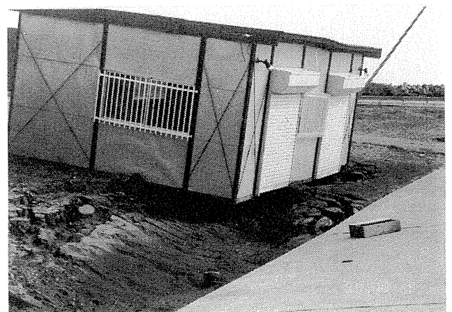
写真-5.2.7 花咲港地区B東岸壁のプレハブ小屋の傾斜 東岸壁背後地盤の沈下により、プレハブ小屋が傾斜した。 Photo-5.2.7 A Stock House Subsided and Inclined (Point B)
