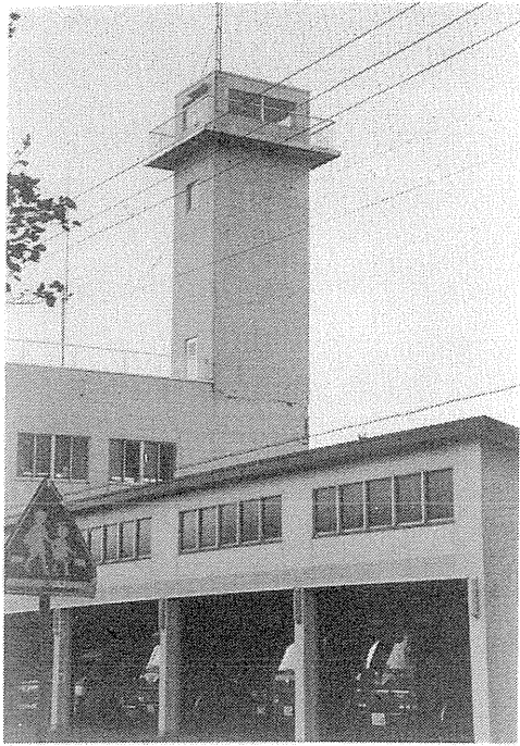
写真-5.1.9 朝日町の消防署の望楼の被害 望楼基部に亀裂が発生した。 Photo-5.1.9 Bending Crack to Tower of Fire Station
