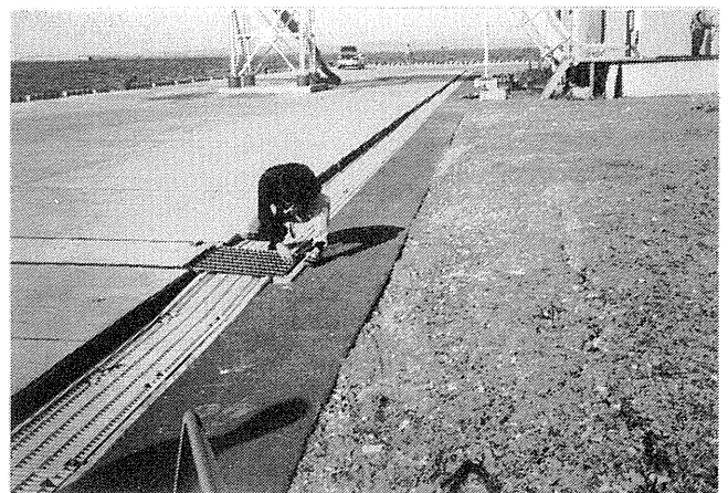
写真-3.1.5 北埠頭における護岸背面地盤の沈下
