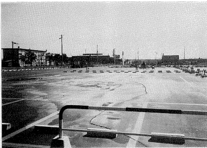
写真-3.2.4 サティ駐車場における舗装の亀裂・噴砂 釧路沖地震の時と同様、同じ場所で液状化による舗装の亀裂・沈下・噴砂が生じていた。前回、この場所は空き地であった。
