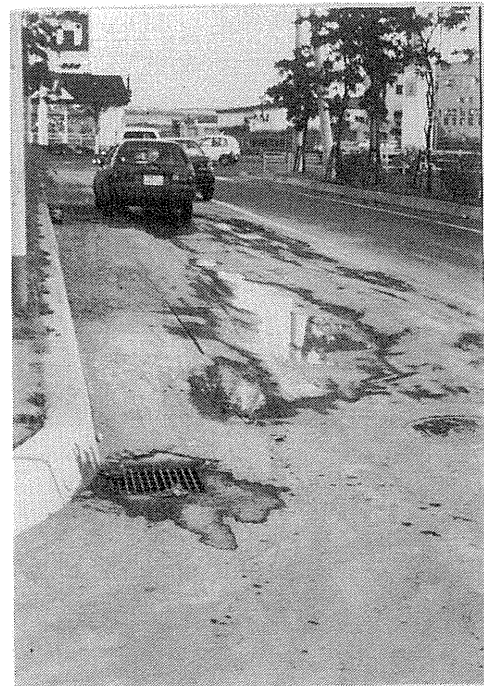
写真-3.2.5 サティ駐車場側道の路面沈下 釧路水面木場から北西方向に延長されるこの付近はかつて水路であり、埋立て造成されている。このためこの付近は液状化による被害が目立っており、写真は下水道管路が破損し、管路内部に土砂が浸入したために上部の路面が沈下したものと推測される。
