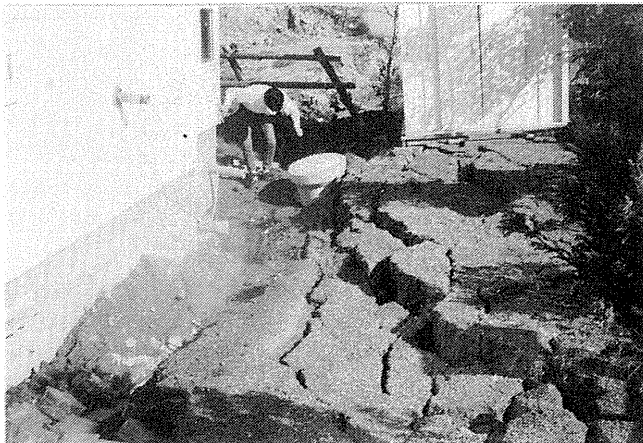
写真-3.3.2 茅沼住宅地 すべりに巻き込まれた家屋 向かって右側で地滑りが発生しており、裏庭の一部が落下。 かろうじて建物は落下を免れているが、沈下および傾斜に より居住は困難と考えられる。 Photo-3.3.2 Damage to A House due to Slope Sliding (Kayanuma Area)
