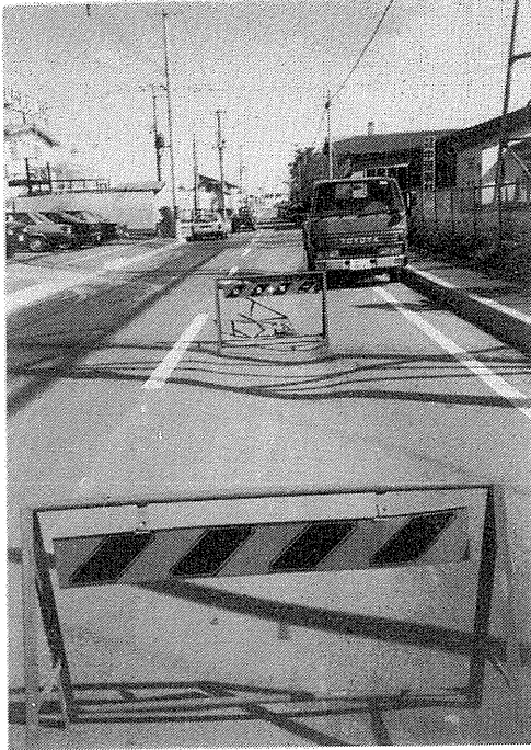
写真-3.2.6 桂木二丁目路面沈下 写真-3.2.5よりさらに北西部に位置するこの付近でも下水 管部分の路面が沈下している。 Photo-3.2.6 Ground Subsidence
