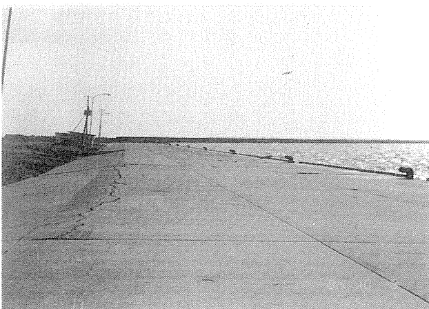
写真-5.2.6 花咲港地区B東岸壁の傾斜 ケーソンが傾斜し、背後地盤が沈下した結果、 舗装面に傾斜が発生した。 Photo-5.2.6 Inclination of Quay Wall Caissons for the quay wall moved and inclined (Point B).
