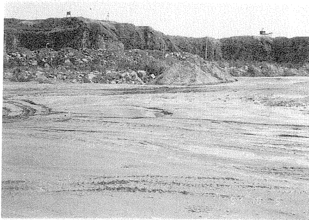
写真-5.2.4 花咲港地区Bでの噴砂 地区Bでの噴砂は全面に亘って発生した。 Photo - 5.2.4 Sand Boils (Point B) A wide area was liquefied at Point B.
