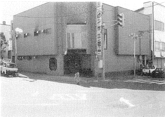
写真-5.1.3 梅ヶ枝町の雑居ビルの火災跡 2階窓付近に火災の跡が見られる。 Photo-5.1.3 Fire of A Commercial Building (Umegeada-Cho)
