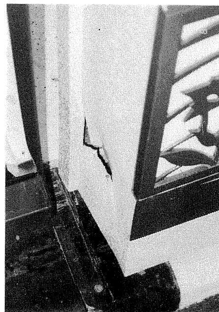
写真-4.2.2 りんどう大橋欄干の被害 震動および盛土崩落による橋桁の変位で欄干が橋台にぶつかり変形した。橋桁と橋台の接合部が約5cm開いたままであった。 Photo-4.2.2 Damage to Gird Rail of The Rindo Bridge The Gird Rail crashed the abutment and was severely deformed.
