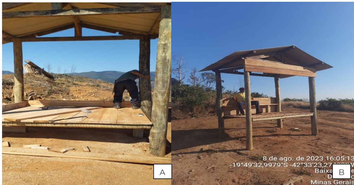
Figura 24. Pontos de observação A) B) Construção de assoalhos em pontos de observação de incêndios florestais, nos morros Garrincha, município de Marliéria, e no morro do Gavião, município de Dionísio.
