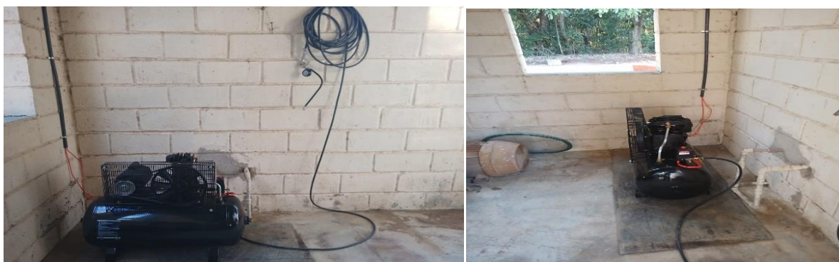
Figura 23. Compressor A) B) Instalação de e limpeza de compressor de ar para viabilizar a manutenção de calibragem de pneus dos veículos da Unidade.
