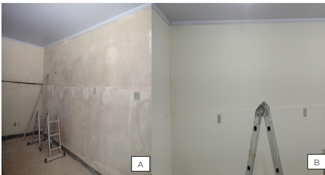
Figura 33. Biblioteca A) B) Pinturas das paredes internas concluídas, com três demão de tinta, sala de armazenamento de materiais didáticos, próxima ao Herbário.
