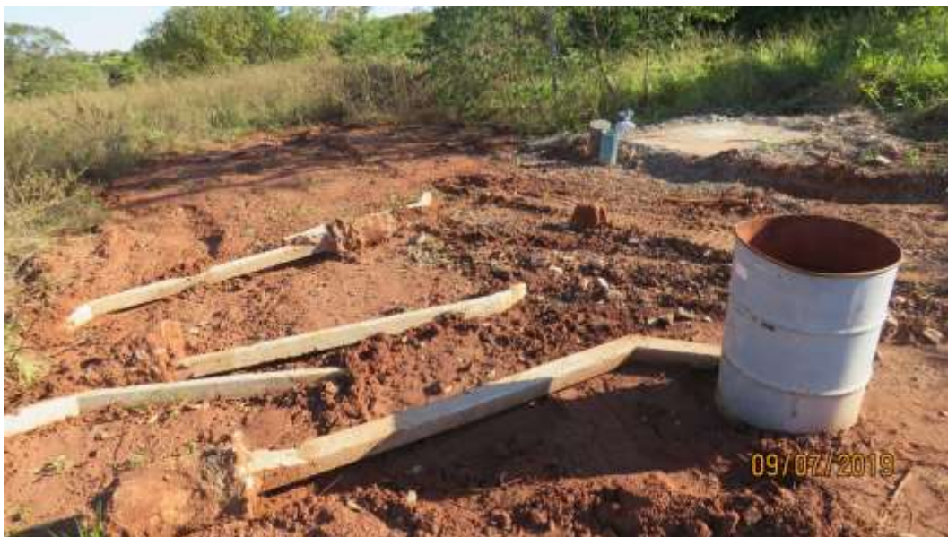
Figura 16. Depois (julho/2019) – Poço desativado e tamponado, ainda há resíduos no local.
