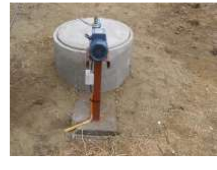
Bomba y sistema de recirculación
