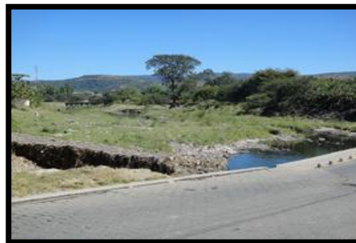
Foto N° 44 Cárcavas formadas por la crecida del río
