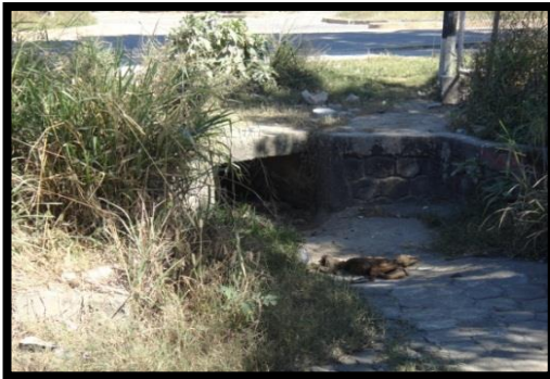
Foto N° 10 Drenaje municipal donde convergen las aguas Pluviales de la SE
