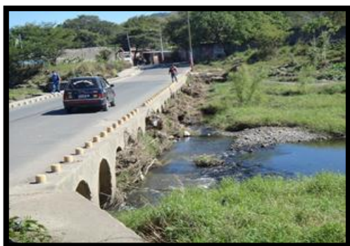
Foto N° 43 Puente casi obstruido totalmente de basura
