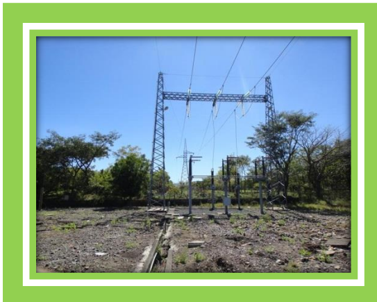
Foto N° 27 área para transformador
