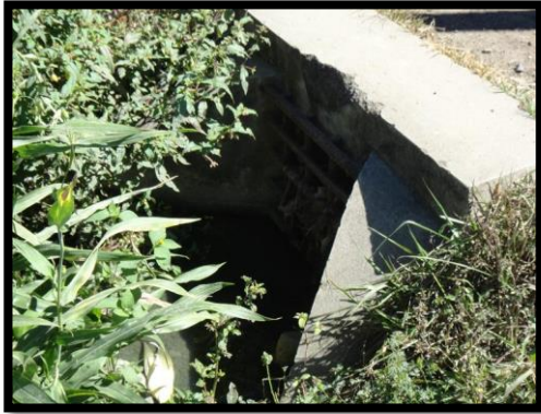
Foto N° 8 Tubería de salida de la Subestación
