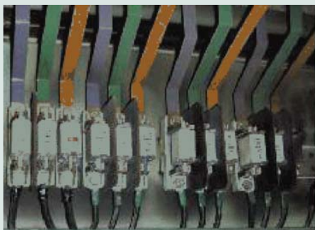
Fusibleak, banagailurik gabe Istripua gertatu zen lekua
