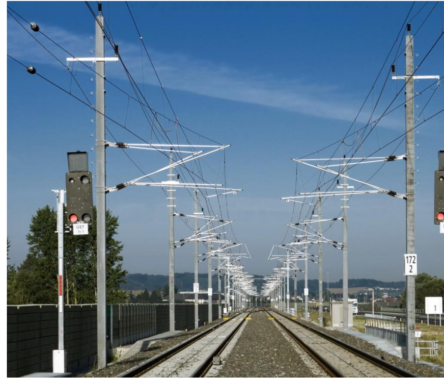
Bild 4.7 Kettenfahrleitung geringer Belastung des Stromabnehmers, vermindert Gefahr des Abhebens bei hohen Geschwindigkeiten
