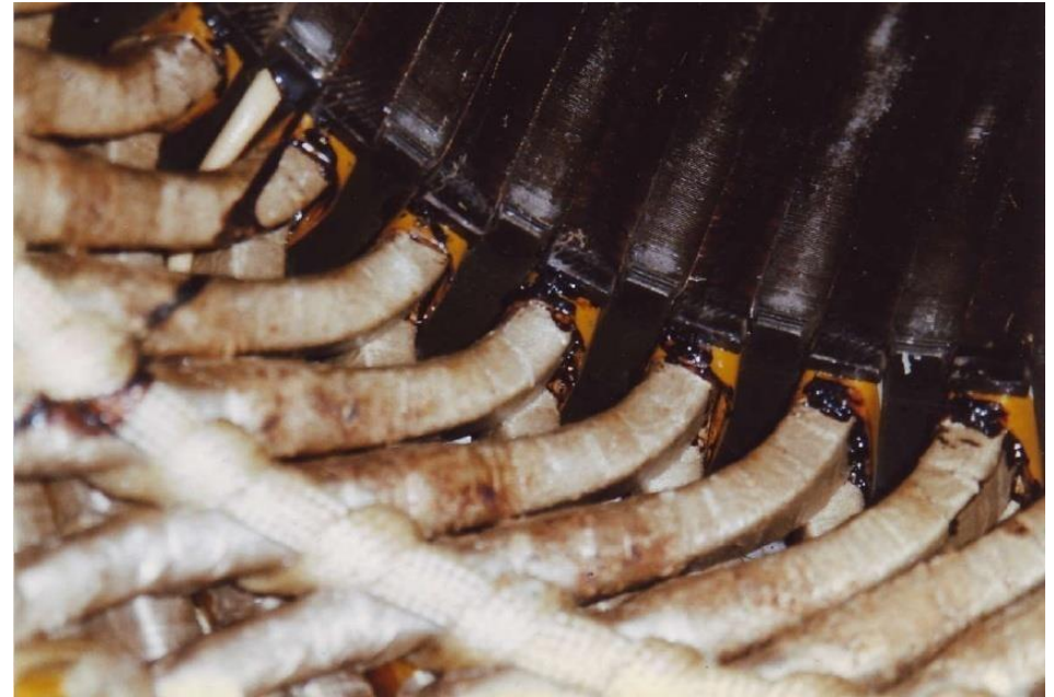
Bild 9.22 Isolationsharz von der Statorwicklung als braune zähe Masse aus der Nut ausgetreten [3]
