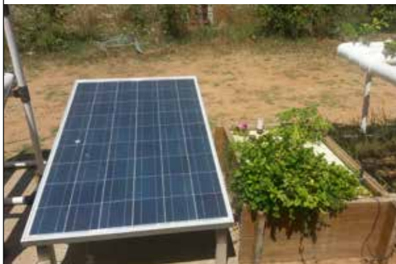
图9.10 用于为水泵供电的光伏电池
