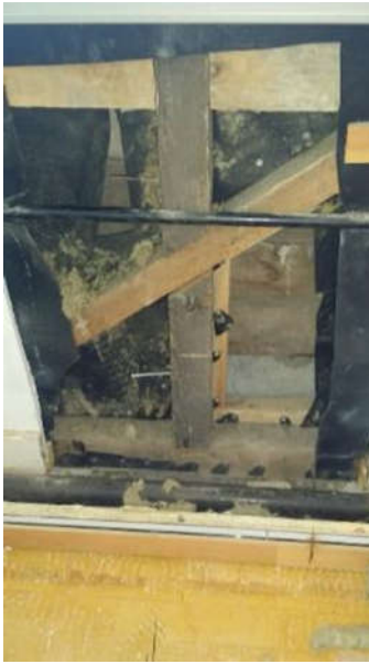
Mynd 27: Opnun á timburútvegg undir glugga í rými 3. Horft er inní klæðningu sem er á steinsteyptum hluta útveggjar.
