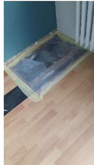
Mynd 30: Opnun í gólfi í rými 7. Plast var sett yfir gatið til varnar. Á því mátti sjá að loftþrýstingur er undir gólfi. Plastið færðist upp og niður vegna þrýstings annarsstaðar frá.
