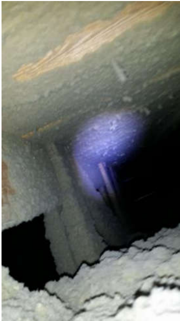
Mynd 23: Séð inní þakrými. Blásin steinullareinangrun og óhreinindi.
