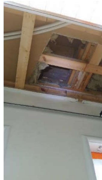
Mynd 24: Séð uppí þak úr rými 3. Búið að rjúfa loftklæðningu. Sjá má tvö lög af loftklæðningum.
