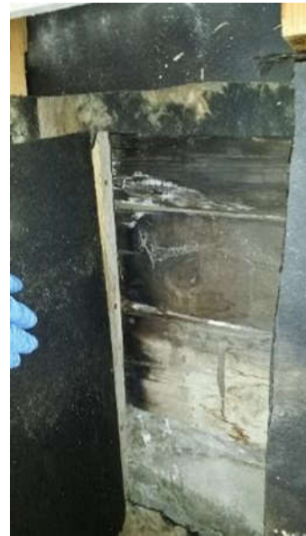
Mynd 28: Opnun á timburútvegg í horni rýmis 8. Miklar rakaskemmdir sjáanlegar í timburhluta veggjarins
