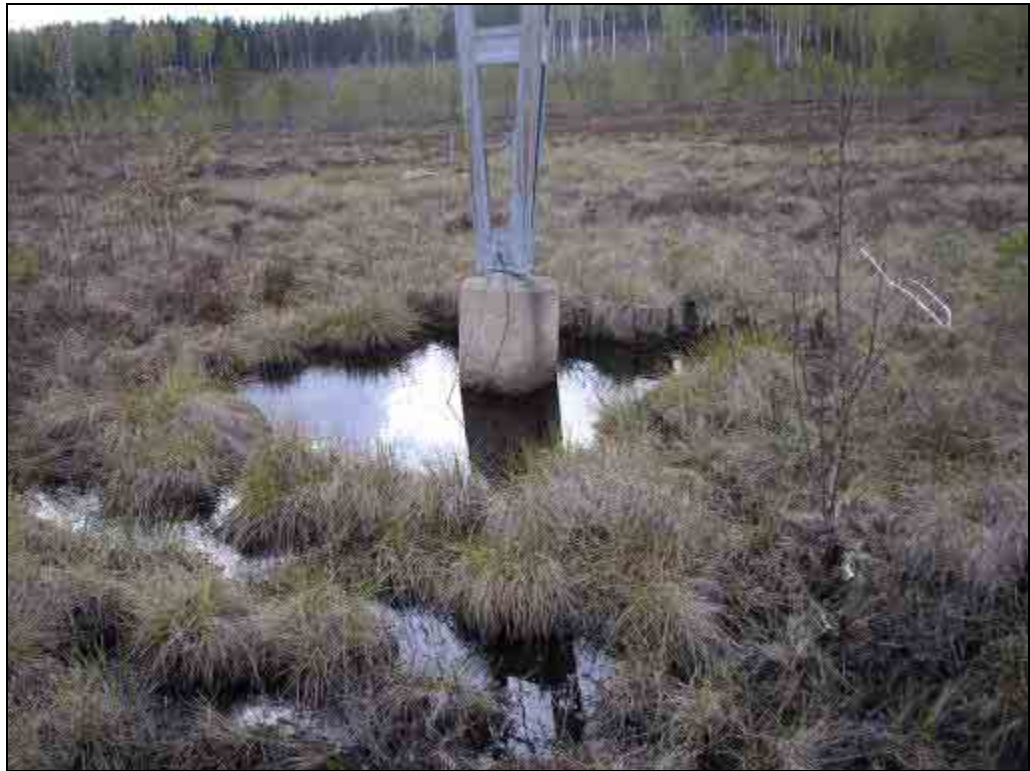
Kuva 5. Natura-alueella nykyisellään sijaitsevan Kangasala-Hyvinkää 400 kV voimajohdon jalan perustus. Kaivannot ovat täyttyneet vedellä. Taustalla näkyy Päterinmäen rinnettä. (Valokuva M. Nuottajärvi)
