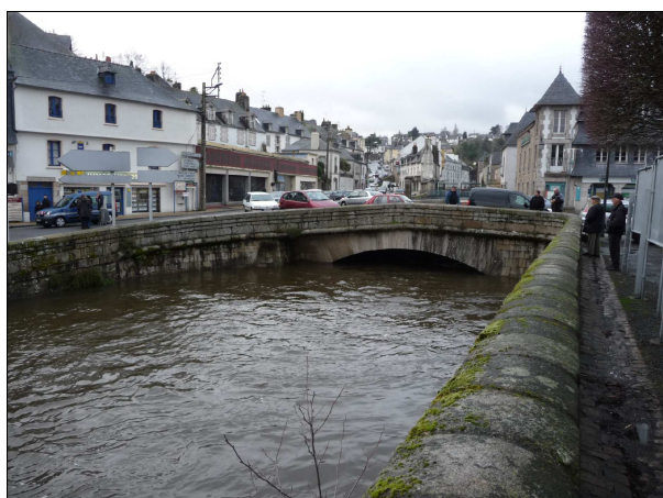
Photo 16: Vue aval du pont du Moulin de la Ville - Quimperlé le 1er mars 2010
