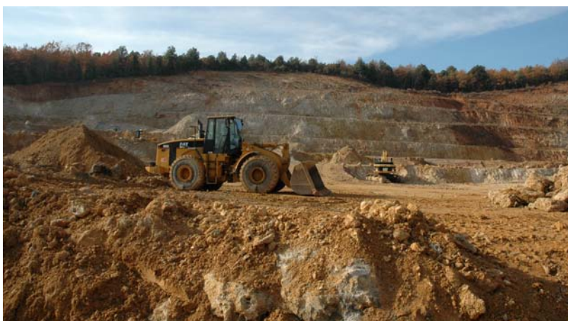
Fig. 7 - Val di Merse (Monteriggioni). Cava attiva di inerti per la pavimentazione stradale.
