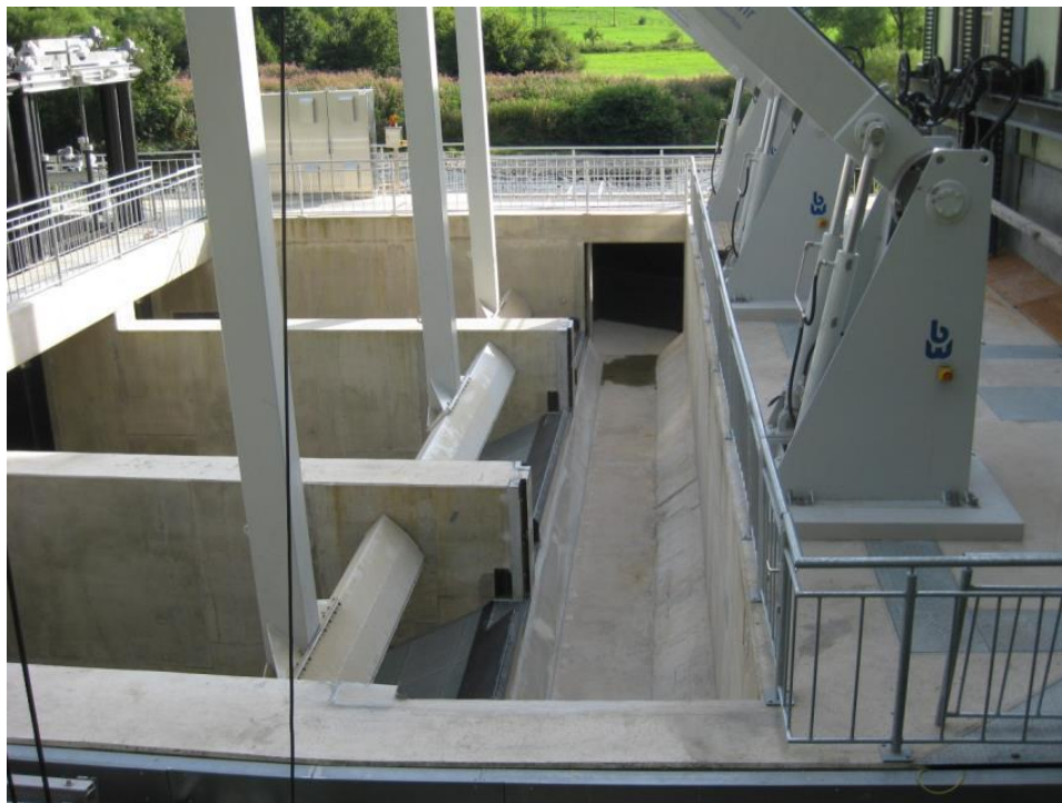
Abbildung 11: Fischabstiegsrinne mit Rechenschürze und Rechenreinigern
