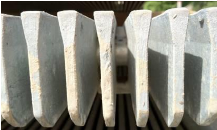
Abbildung 7: Feinrechenprofil in Y-Form der Maschine 2 vor Umbau 2015
