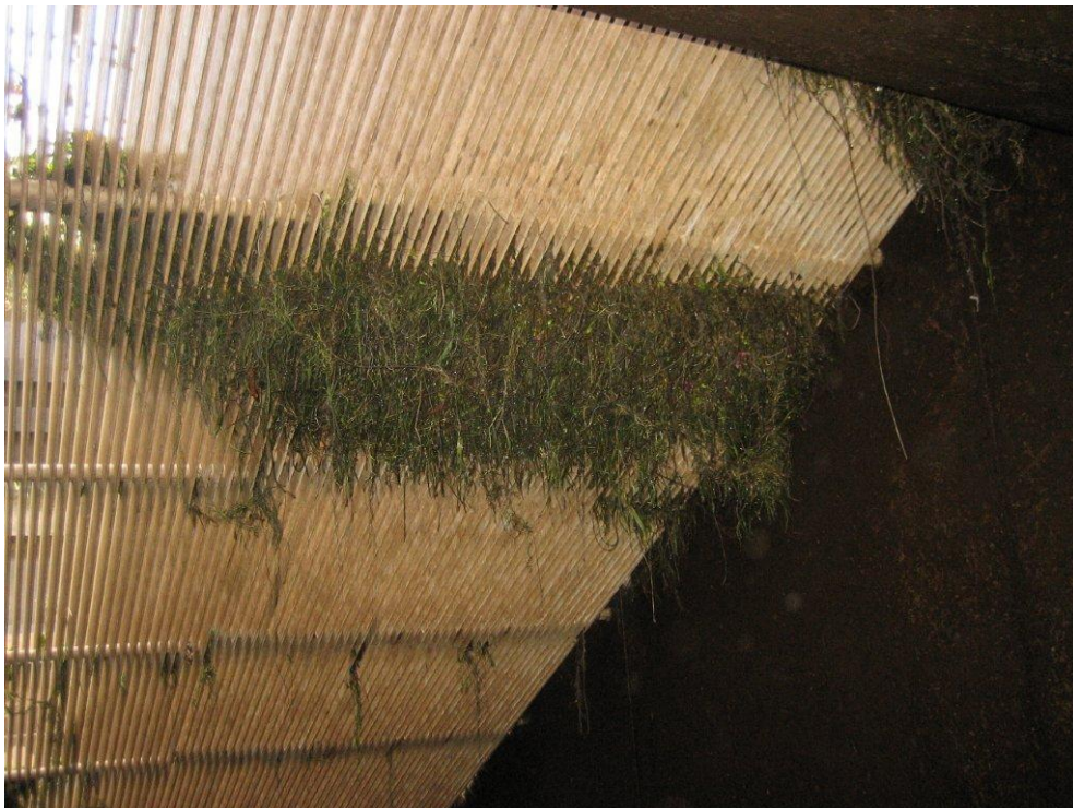
Abbildung 27: An den Füllelementen gehaltenes Geschwemmsel (Ansicht Rechen 2 von hinten, August 2014)
