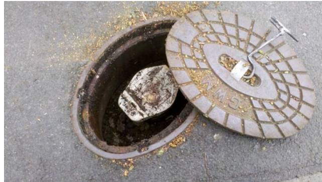
Abb. 24: Grundwassermessstelle in der Straßendecke (Quelle: LANUV NRW)
