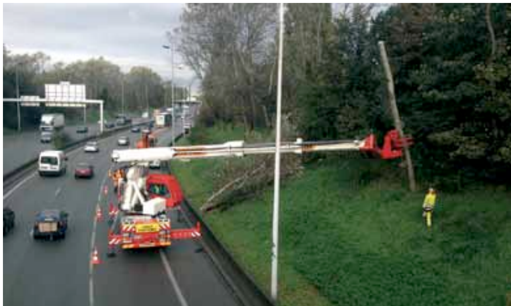
Le Piveer permet de démonter et de déposer un arbre tout en évitant les impacts sur le lieu d'abattage. Il est particulièrement approprié sur les routes et autoroutes où seule l'emprise d'une voie sera nécessaire.
