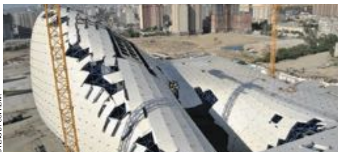
Étanchéité en toiture de la Maison de la culture de Bakou, en chantier.
