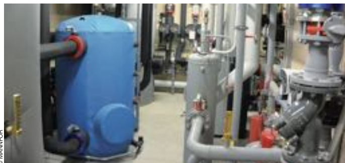
Chauffière où a lieu l'échange entre les sondes géothermiques et le circuit de chauffage et de climatisation de l'Espace des mondes polaires à Prémanon (Jura).
