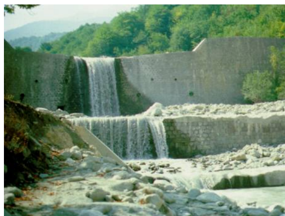
Φράγμα συγκράτησης φερτών υλών στο χειμαρρο Όρμας Αριδαίας
