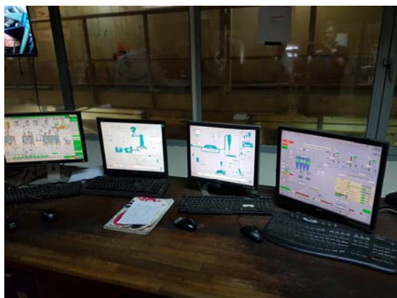
Κέντρο ελέγχου λειτουργίας βιομηχανίας παραγωγής προϊόντων ξύλου
