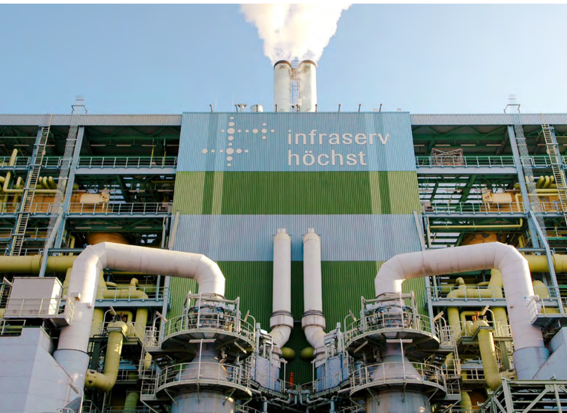
Klärschlammverbrennungsanlage zur Entsorgung von Klärschlämmen bei gleichzeitiger Dampferzeugung.
