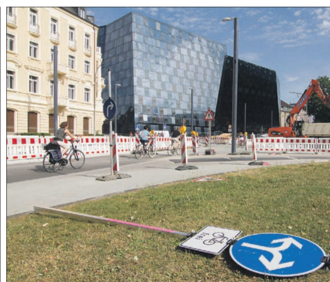
Pünktlich zur Eröffnung der neuen UB ist jetzt auch die Kreuzung wieder befahrbar. (Foto: A. J. Schmidt)
