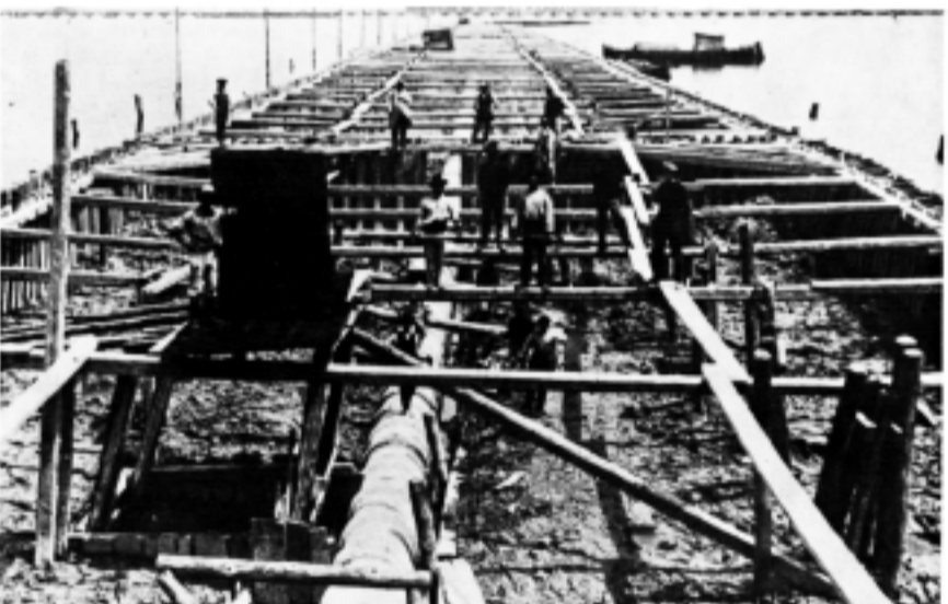
L'impresa di Angelo Baviera di Vigonovo di Pordenone, impegnata nel 1909 nei lavori di arginatura del Danubio a St. Pölten (Austria); una veduta delle strutture di impalcatura (Civica Biblioteca di Vigonovo, Pordenone; foto di proprietà di Nilo Pes; riproduzione di M. De Martin).
