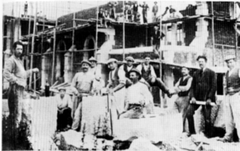
Arras, Pas de Calais (Francia) 1924: tra gli operai friulani c'era anche Tranquillo Rosa che allora dirigeva la costruzione di quattro chiese contemporaneamente.
