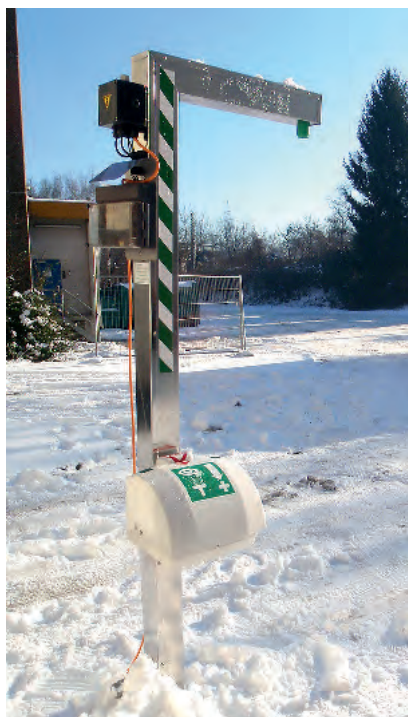
Notdusche im Winterbetrieb / Safety shower in wintertime
