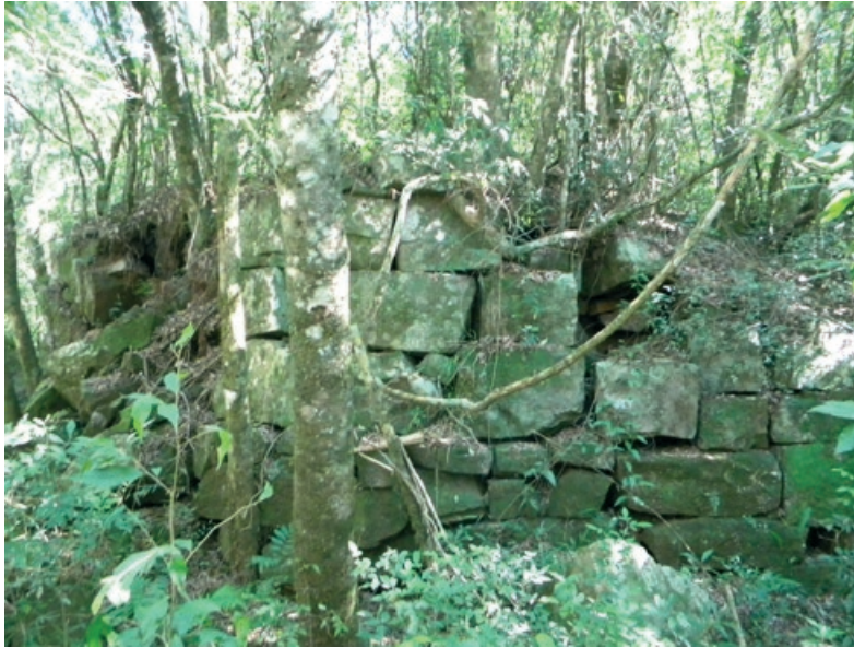
Figura 14. Uno de los pilares del puente de la anti-gua Ruta 12 sobre el Arroyo Santa Ana (2012).
