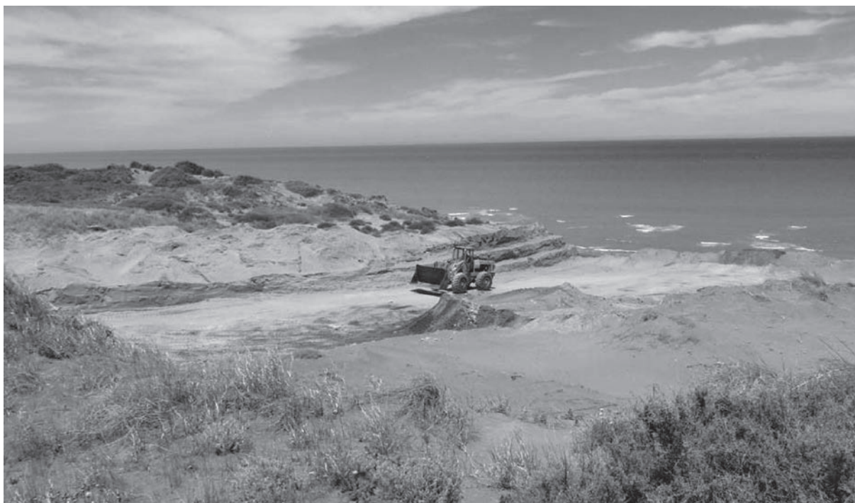
Foto 5. Territorio de nidificación de Falco peregrinus en 2014. Estas obras clandestinas, que se iniciaron en 2015, pretendían un acceso a la playa destruyendo el acantilado. Se presume que la pareja abandonó el área e intentó reproducirse, finalmente sin éxito, en cercanía a otras dos parejas del núcleo del ANP Punta Bermeja. Foto obtenida del portal del gobierno de la provincia de Río Negro. http://www.rionegro.gov.ar/index.php?contID=26930
