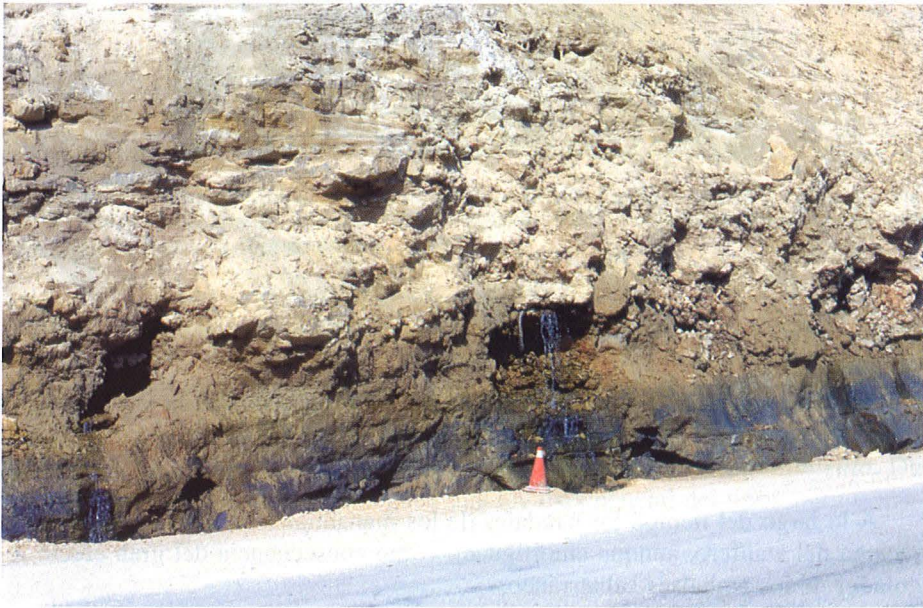
Foto 5.3. Los límites impermeables constituyen superficies a favor de las cuales se establecen líneas de flujo desde los acuíferos. El agua subterránea aparece en forma de rezumes o de manantiales. Foto: N-623 entre Covanera y Escalada (Burgos), 1992.
