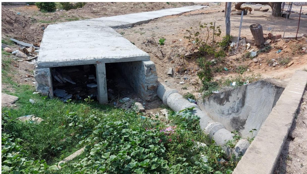
Figura 38 - Bueiro Duplo Capeado de Concreto Fonte: Instituto Gesois, 2020.
