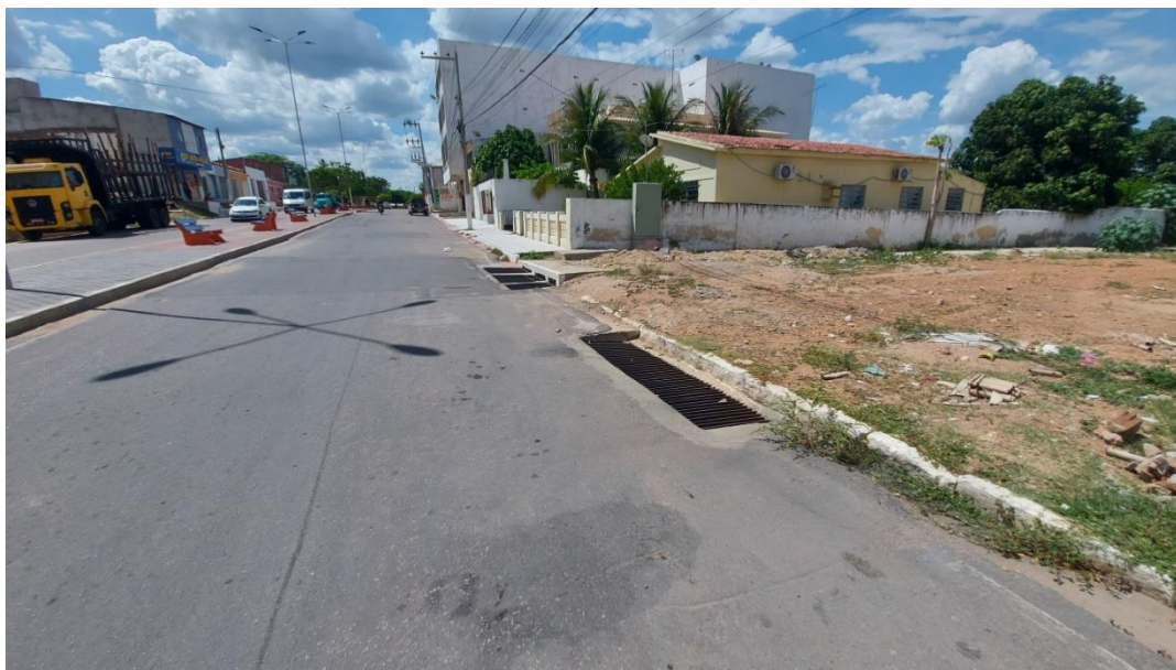
Figura 40 - Boca de Lobo Simples Fonte: Instituto Gesois, 2020.
