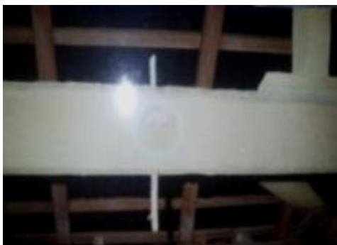
Figura 64. Cono en viga de madera.
