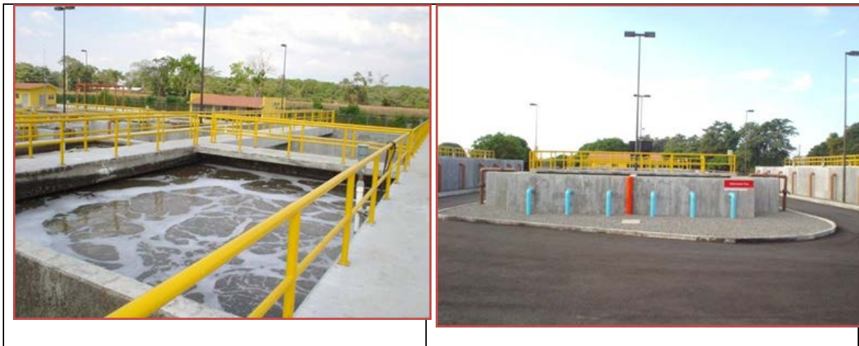
Figura 6.10 Reactor biológico aerobio y Sedimentador secundario
