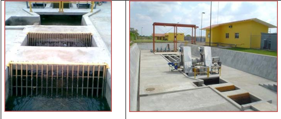
Figura 6.8. Fotografía Rejilla manual y mecánica
