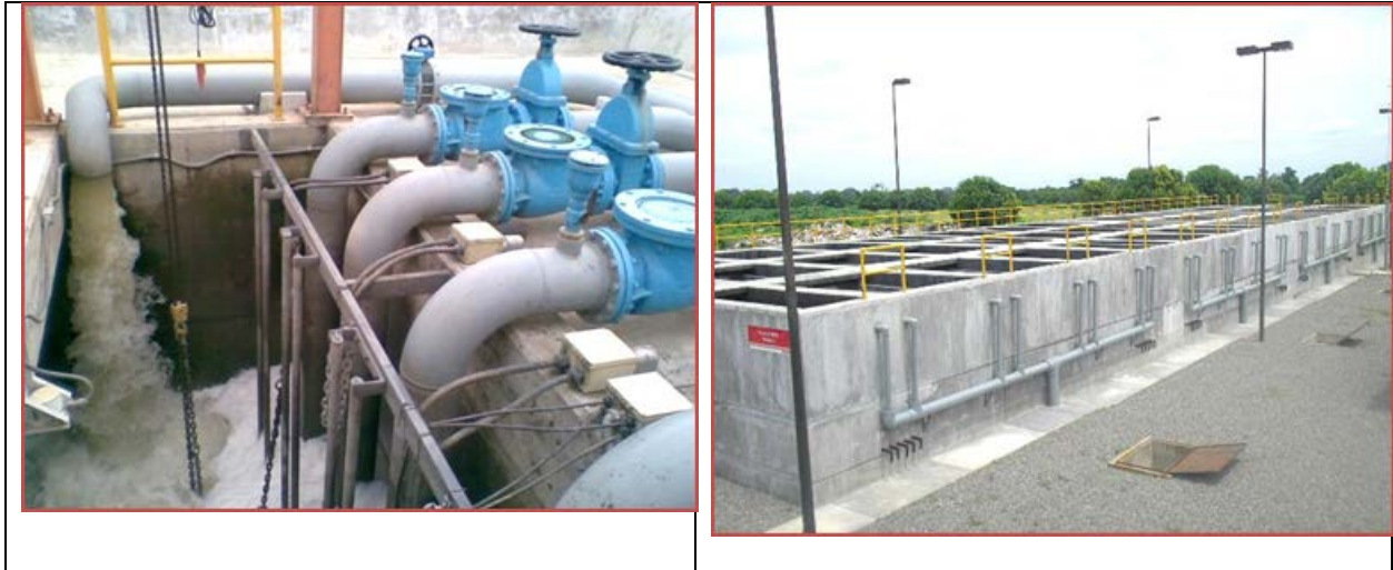
Figura 6.9. Bombas sumergibles y Reactor anaerobio UASB
