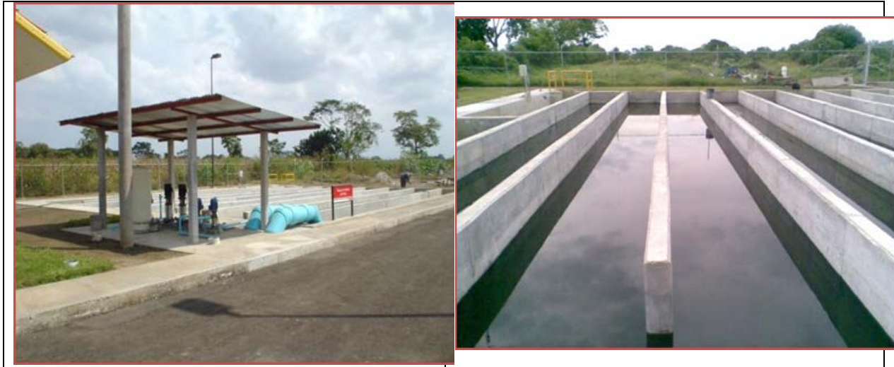
Figura 6.11 Área de desinfección con cloro y Tanque de contacto
