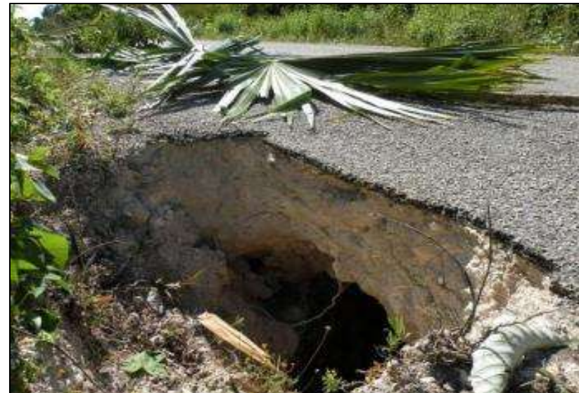
Hundimiento en la carretera de acceso al poblado de Nuevo Durango, Quintana Roo, por el colapso del techo de una cavidad kárstica
