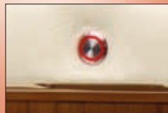
Schalter für Zentralheizung
